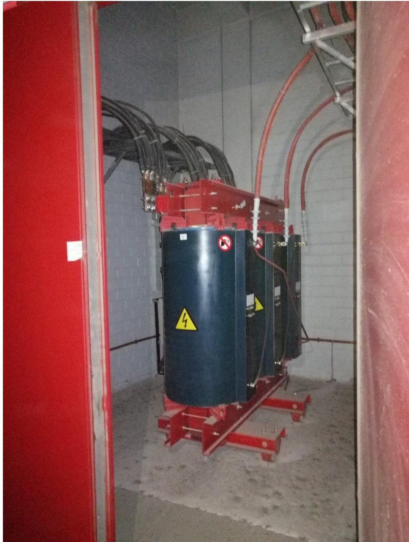
Εικόνα 3: Μετασχηματιστής Ξηρού Αέρα Νο3
